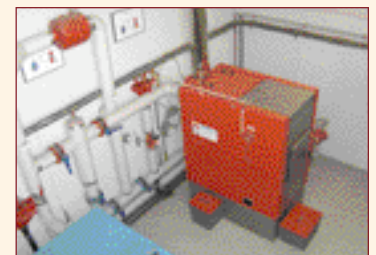
Chauffe-bois à Beauregard-et-Bassac
